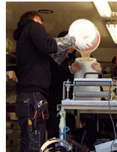
Risiko for spild af uhærdet epoxy
